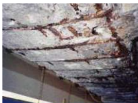
塩害による鉄筋腐食の例
